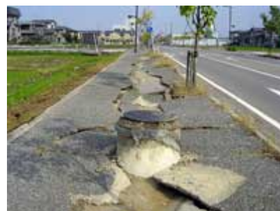
Βλάβες από σεισμό σε πεζοδρόμιο
