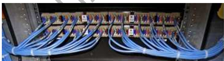
Εικόνα 4: Τερματισμός καλωδίων στο πίσω μέρος του Patch Panel και του ικρίματος
