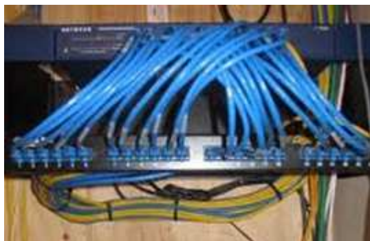
Εικόνα 5: Σύνδεση πίνακα μικτονόμησης και switch για την υλοποίηση του τοπικού δικτύου (εμπρός μέρος ικριώματος και Patch Panel)
