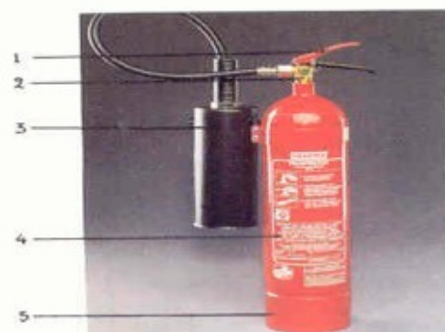
Πυροσβεστήρας διοξειδίου του άνθρακα (CO 2 ) 6 χιλιογραμμών
