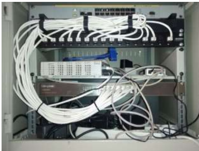
Εικόνα 151: Rack σχολικού εργαστηρίου με Switch & Patch-panel.
