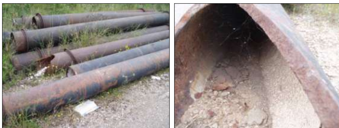
Σιδηροσωλήνες που μετέφεραν την τέφρα
