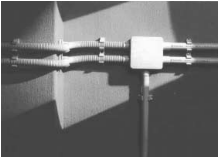
Σχ. 3.1 Τμήμα ηλεκτρικής εγκατάστασης ορατής, όπου φαίνονται διάφορα υλικά που χρησιμοποιούνται.
