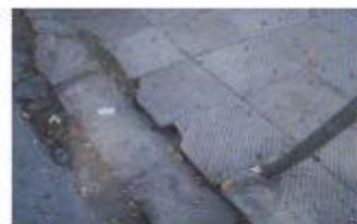
Στην οδό Ντομαρά καταστραμμένη ράμπα ...
