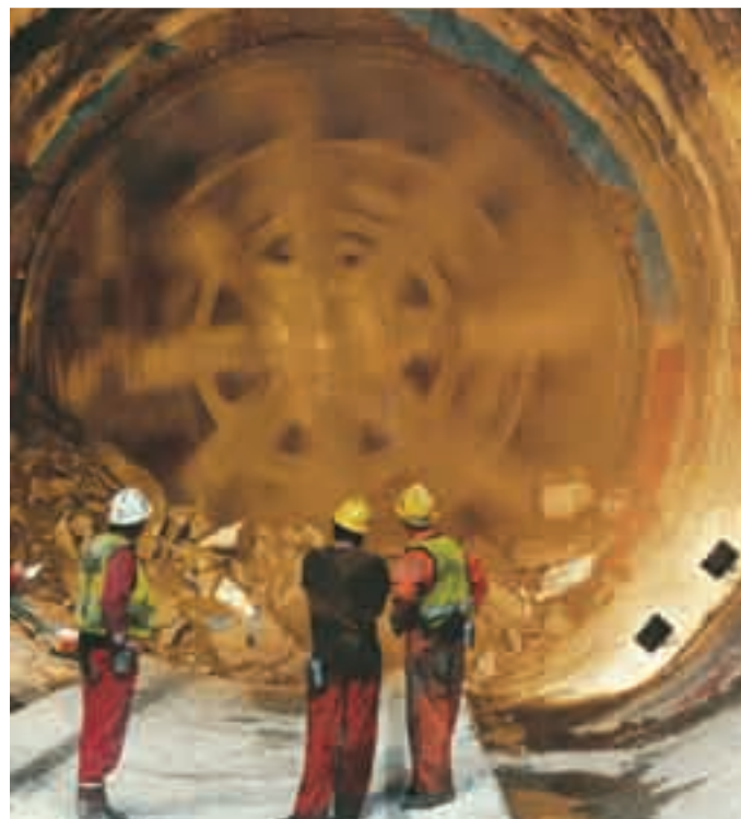
Μηχανικός εκσκαφέας που χρησιμοποιήθηκε για τη διάνοιξη της Σήραγγας της Μάγχης επί τω έργω.
