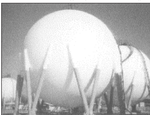
Εικόνα 7.1.2 Σφαίρα αποθήκευσης υγραερίου σε διυλιστήριο
