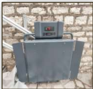
Εικόνα 91. Αναβατόριο κλίμακας με πλατφόρμα (1ο Δημοτικό σχολείο Καρπενήσιου)
