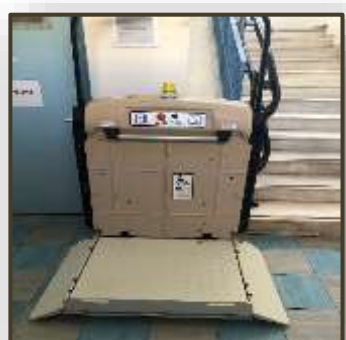
Εικόνα 98. Αναβατόριο (Ειδικό Δημοτικό σχολείο Ερμούπολης)
