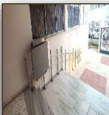
Εικόνα 96. Αναβατόριο κλίμακας με πλατφόρμα (6 ο ΓΕ.Λ. Ιλίου)
