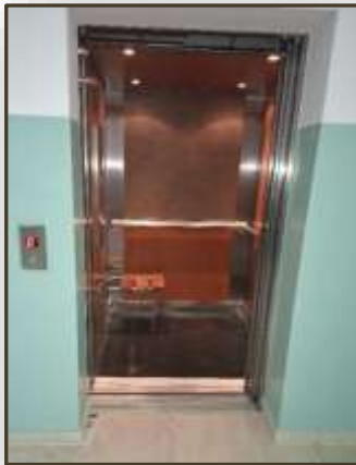
Εικόνα 87. Ανελκυστήρας (1 ο Δημοτικό σχολείο Αρχάνων Ηρακλείου Κρήτης)
