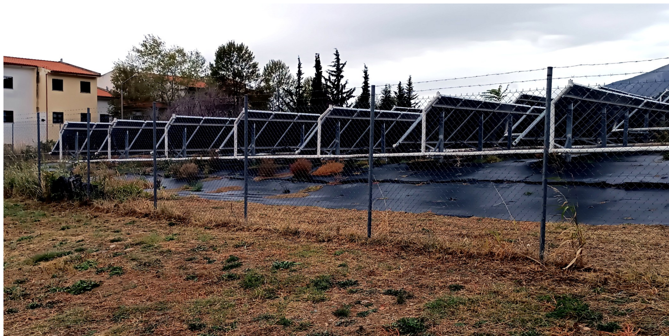
Ηλιακό θερμικό πεδίο
