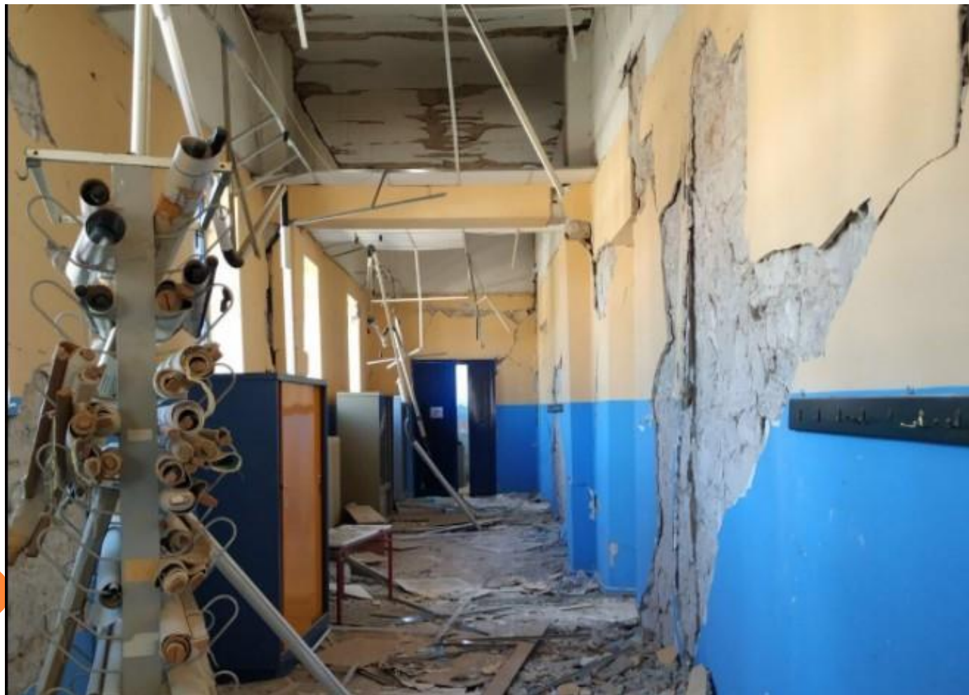
Δημοτικό σχολείο στο Λαμία μετά τον σεισμό της 4 ης Μαρτίου 2021
