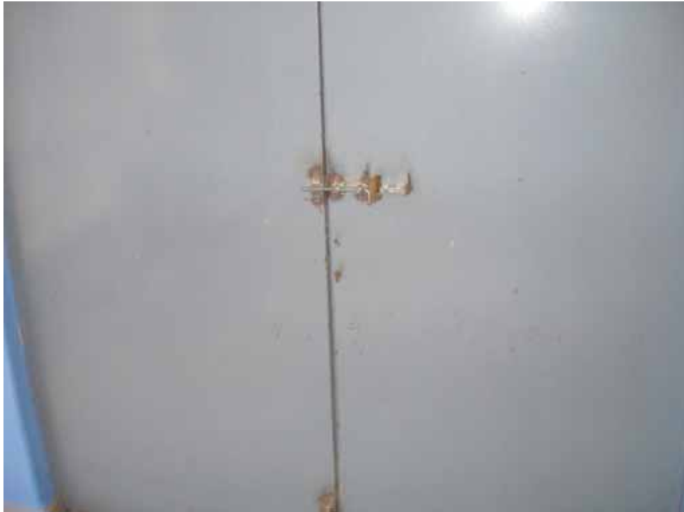
Φωτ.5: Έξοδοι κινδύνου χωρίς αυτόματο μηχανισμό ανοίγματος.
