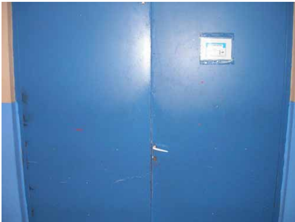
Φωτ.5: Έξοδοι κινδύνου χωρίς αυτόματο μηχανισμό ανοίγματος.
