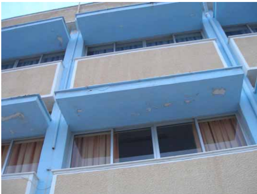
Φωτ.2: Διογκωμένα επιχρίσματα στα ηλιοπετάσματα.
