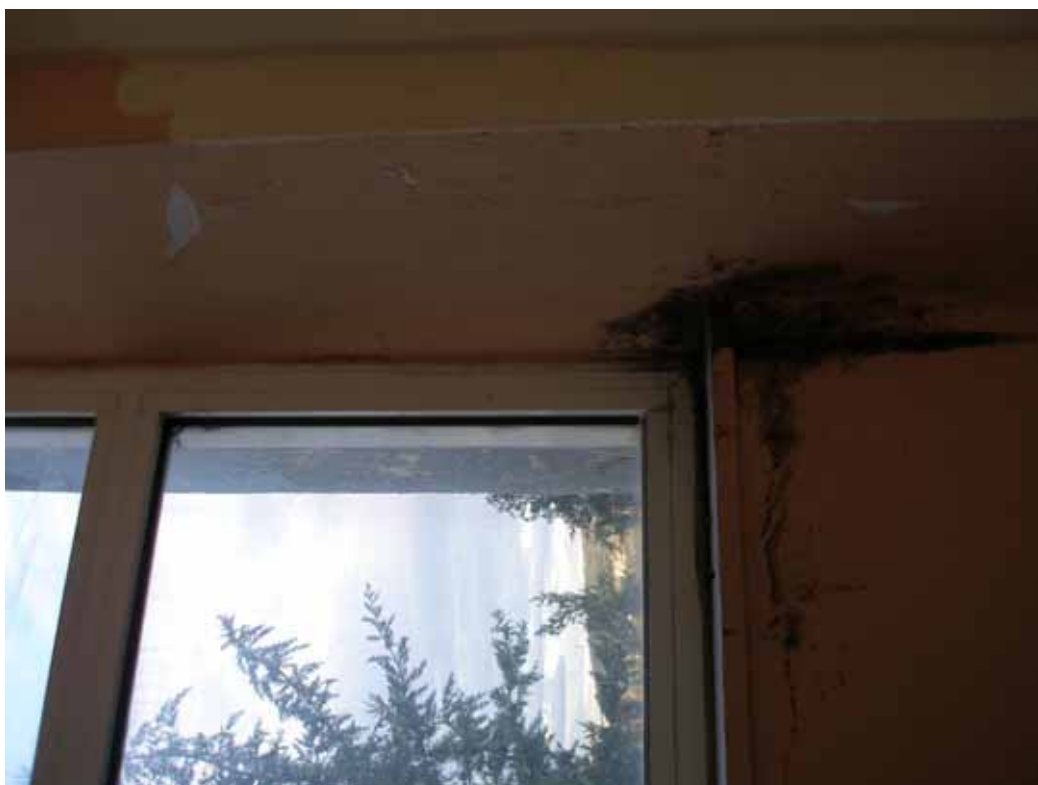
Φωτ.1:Εισροή υδάτων στον βόρειο φεγγίτη.
