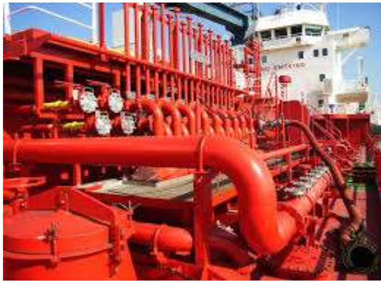
Σύστημα σωληνώσεων σε καράβι.
